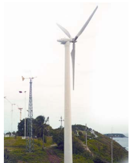
กังหันลม ขนาดกำลังผลิต 150 กิโลวัตต์ ที่สถานีพลังงานทดแทนพรหมเทพ จ.ภูเก็ต
